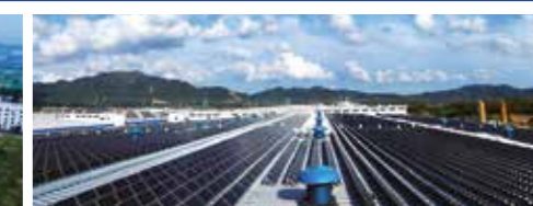
Панели солнечных батарей
